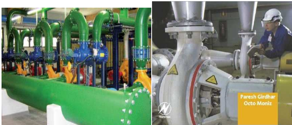
Fig. 5.6 Pompes à axe horizontal installées en fosse sèche
