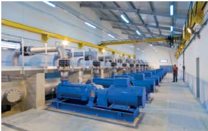
Fig. 5.10 Station de pompage pour l'irrigation équipée de 9 groupes multicellulaires horizontaux, puissance unitaire 400 kW
