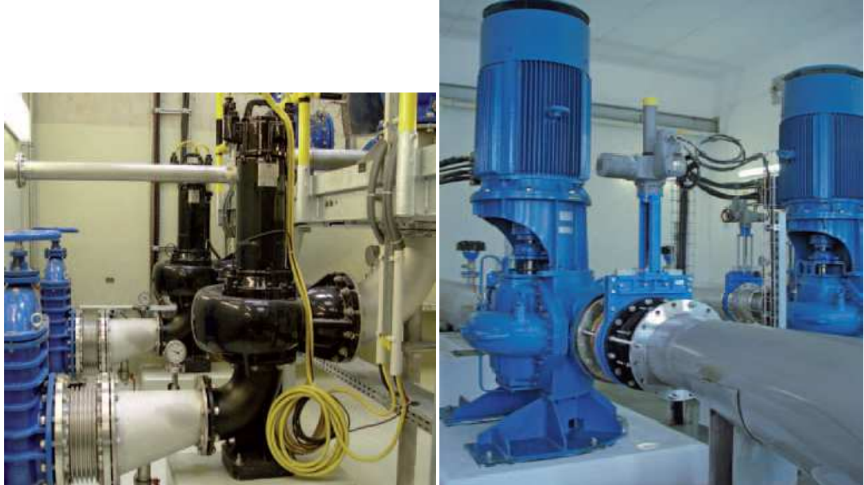
Fig. 5.5 Pompes à axe vertical installées en fosse sèche
