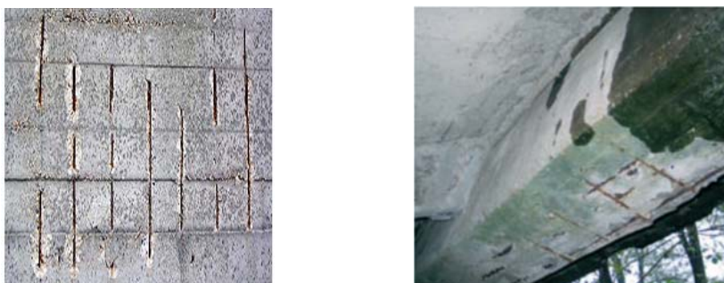
Figure 1 : Photos présentant le cas d'une carbonatation atmosphérique
