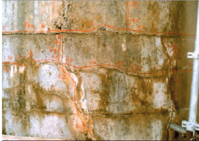
Pile de pont affectée par une réaction de gonflement due à la formation d'ettringite différée
