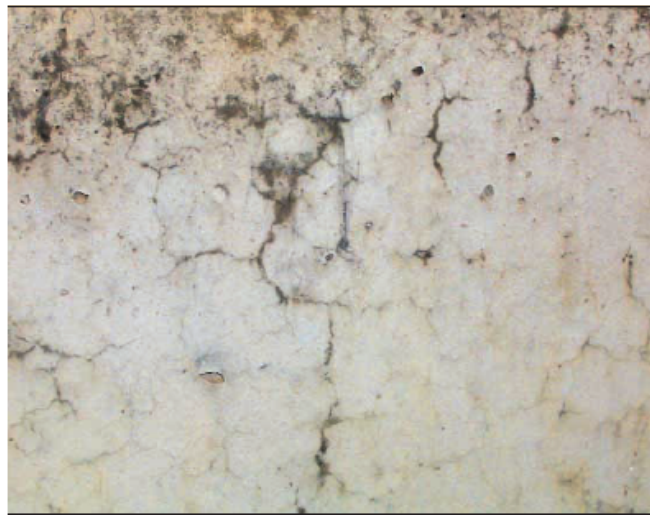
Exemple de faïençage des parements pouvant correspondre à des désordres dus à la formation d'ettringite expansive
