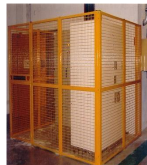
Figure 4.5 : Utilisation d'obstacle : grillage (protection collective)
